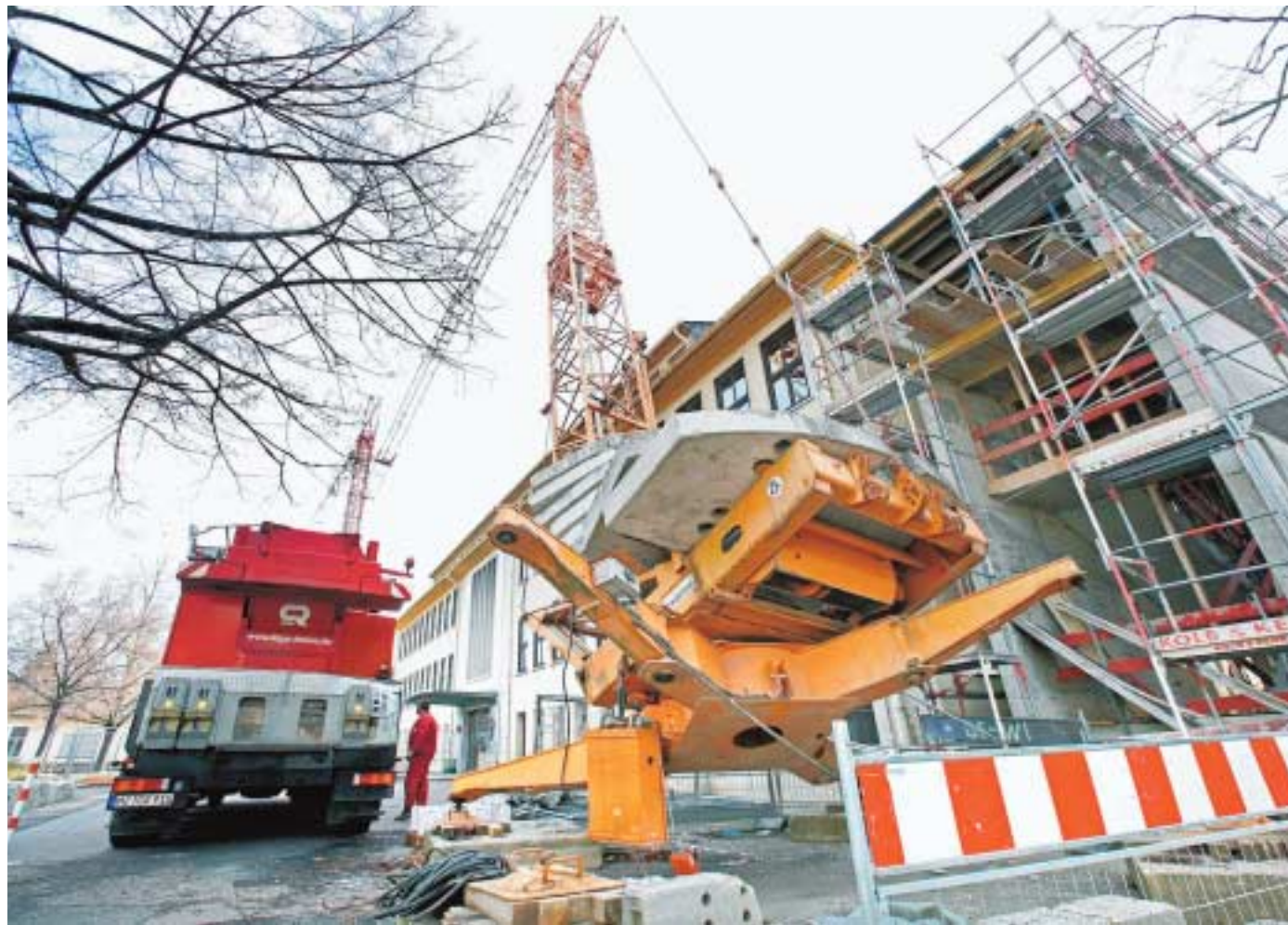
Nach dem schweren Arbeitsunfall kamen die Bauarbeiten an der Brüder-Grimm-Schule zunächst zum Erliegen.
