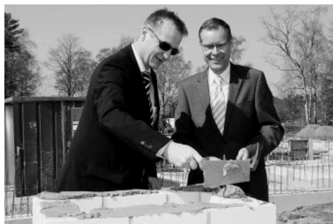
Mit Maurerkelle und Hammer: Innenminister Ralf Jäger (l.) legt Speiß für die Grundsteinplatte auf, Güterslohs Landrat Sven-Georg Adenauer steht zum Festklopfen parat.
